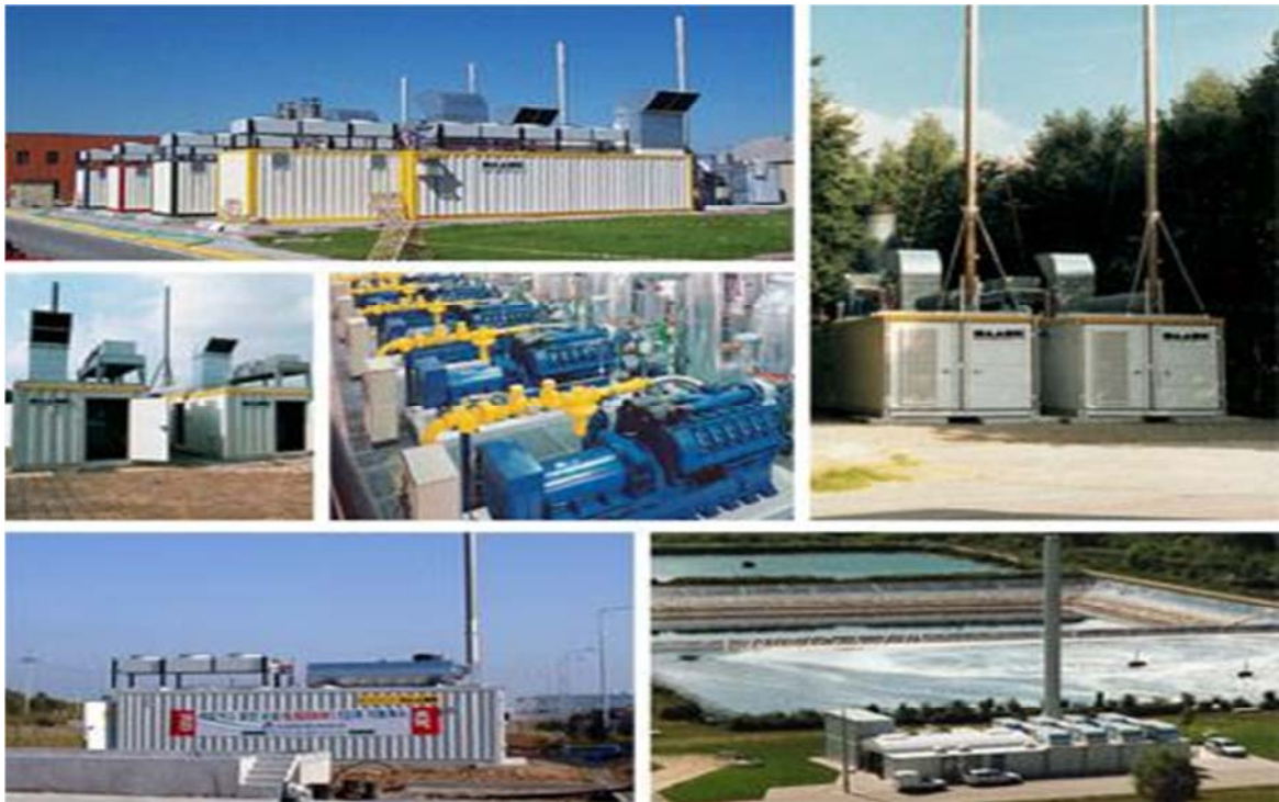
รูปตัวอย่าง cogeneration plants: Heat and electricity from Biogas
