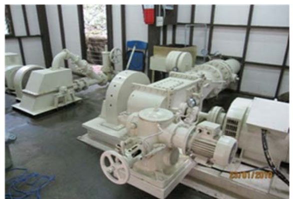
เครื่องกังหันน้ำโรงไฟฟ้าพลังน้ำแม่กำปอง 1,2
